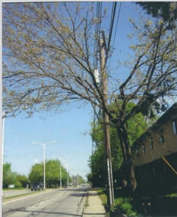
大型喬木種植在電線桿下方，造成立地空間不足。
